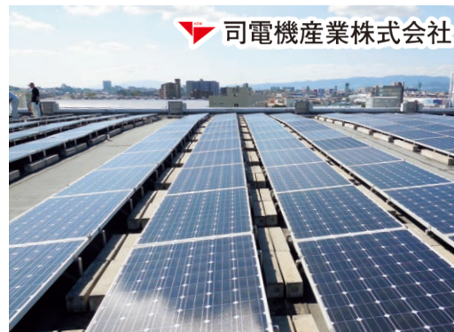
▲設置済みの太陽光パネル
