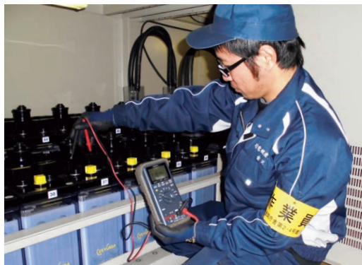
▲蓄電池のメンテナンス
