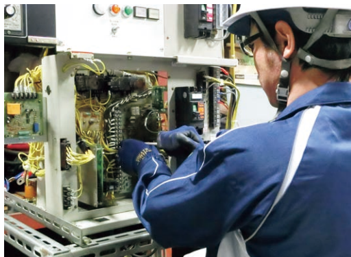
▲直流電源装置(充電器)のメンテナンス
